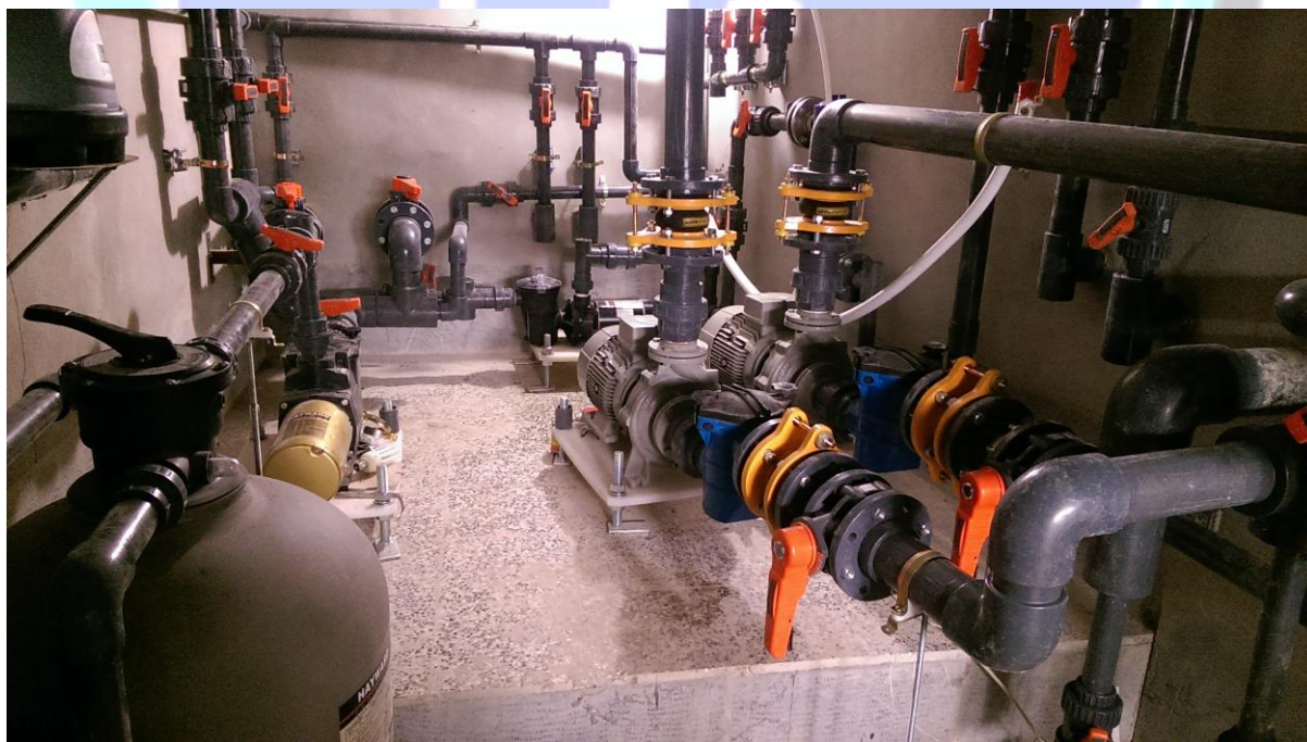
تصویر محل قرارگیری پمپ در یک موتورخانه استخر
